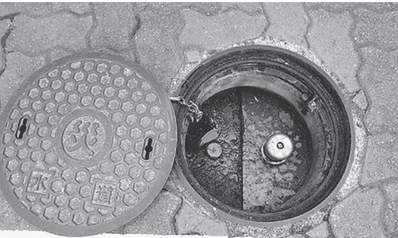
応急給水設備
